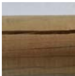
Cracks/Grietas/Fente/Risse/ Crepe/ Barsten/Fendas
